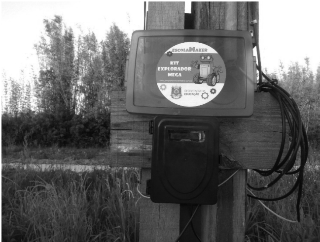
Figura 19 — Instalação completa de todo o sistema
